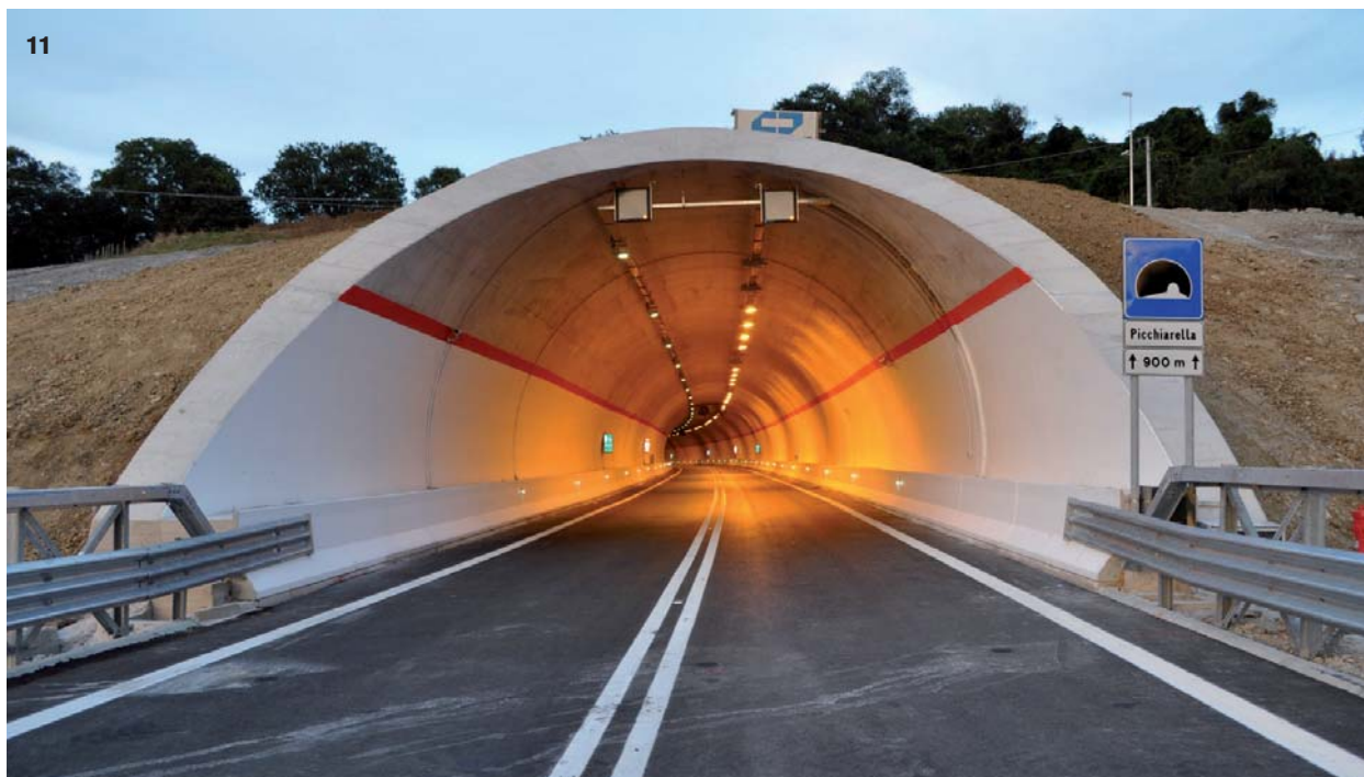
11. Impianto SAP 12. Tecnologia Led 13. Galleria con lampade a induzione magnetica
